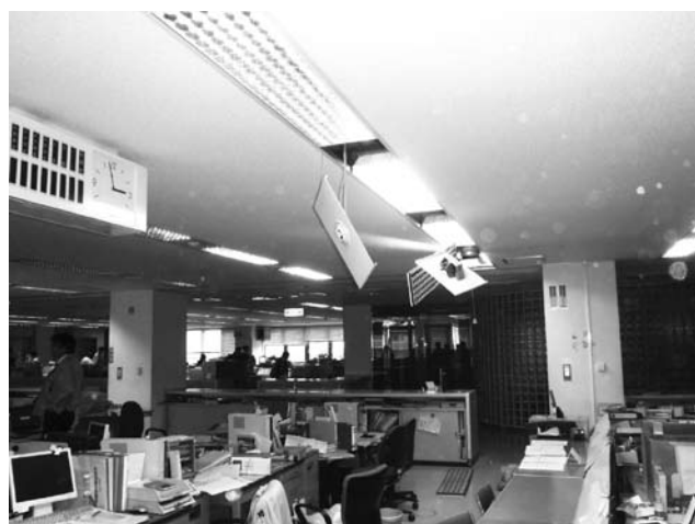
大野田庁舎4階天井の空調の吹出し口などの脱落
