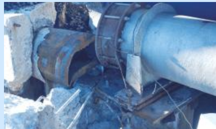
▲ 他県における地震により破断した水道管 (令和6年能登半島地震)
