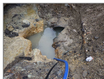
図 2.10 破損管の全景
