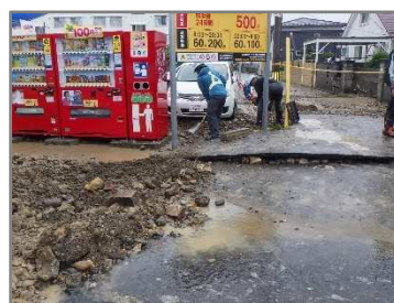
図 2.25 市道部分の舗装版隆起
