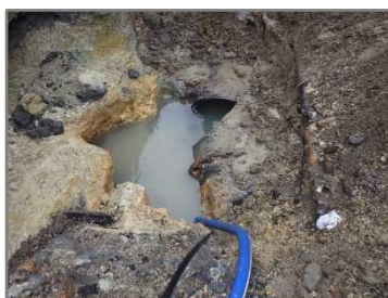
図 1.2 止水後の事故管路
