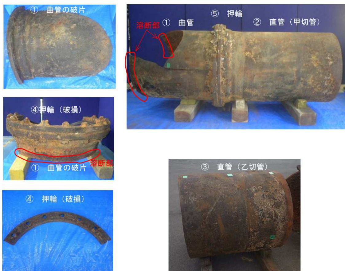
図 4.1 調査対象管の状況
