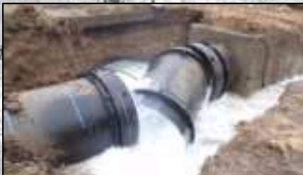
県広域送水管破損
